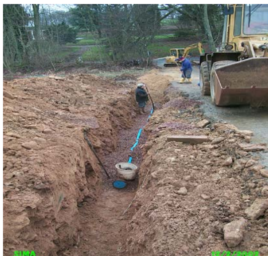
Conduite d'eau Vugelsmillen-Berdorf
