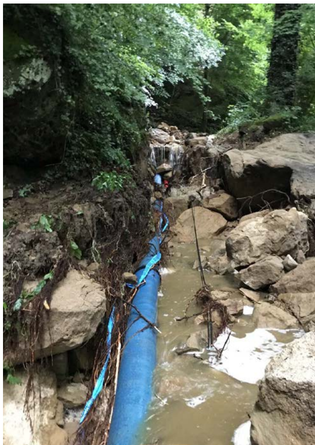
Eine Beschädigung durch Felsbrocken stellt eine
